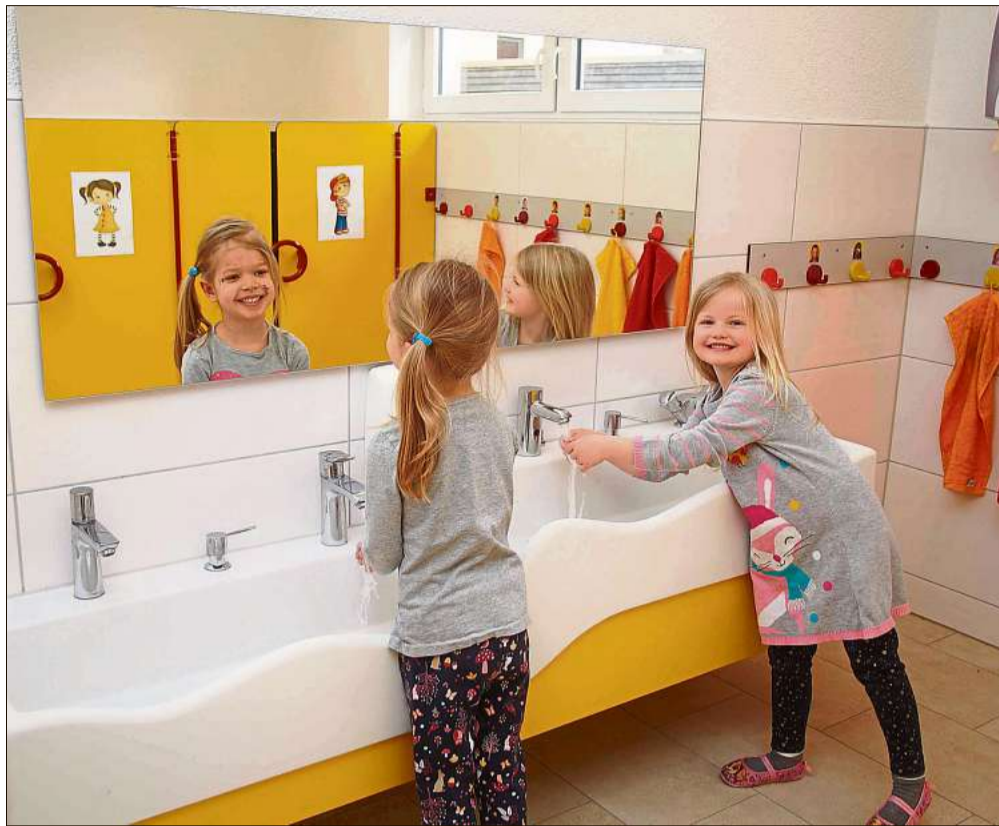
Sehr gut gefallen den Kindern auch die Waschbecken in den neuen Sanitärräumen. Foto: Heimpel
