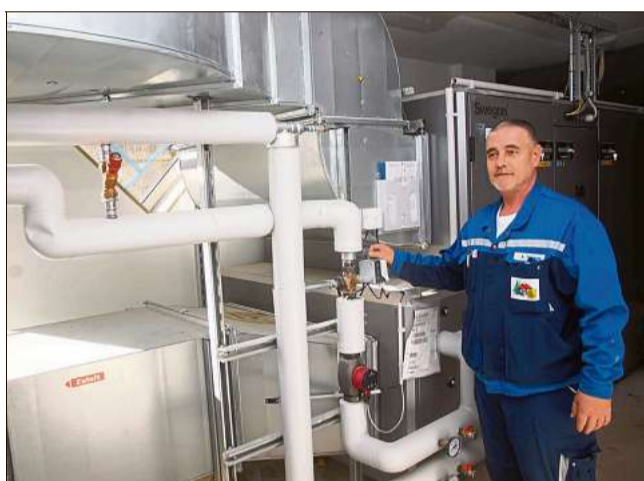
Von außen häufig nicht sichtbar wurde die Technik in der Mehrzweckhalle in Gütenbach deutlich aufgerüstet. All dies muss – wie hier die moderne Lüftungsanlage – von Hausmeister André Thieme betreut werden. Foto: Heimpel
