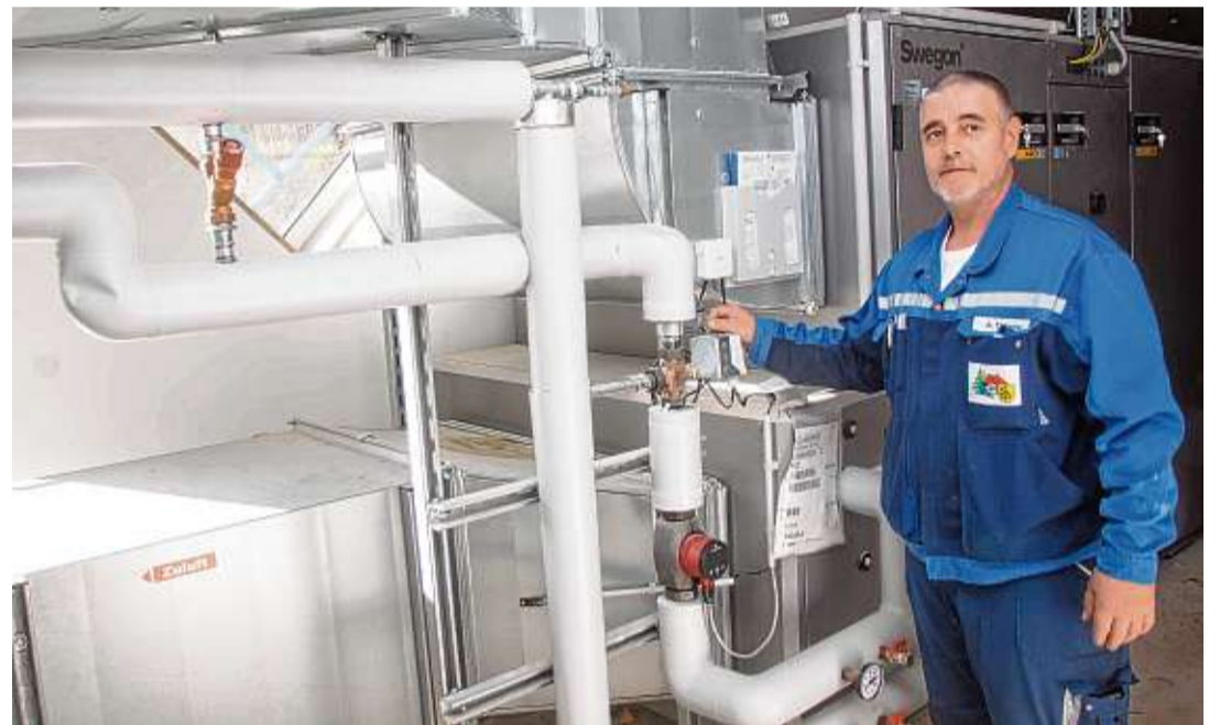
Von außen häufig nicht sichtbar, wurde die Technik in der Mehrzweckhalle in Gütenbach deutlich aufgerüstet. All dies muss wie hier die moderne Lüftungsanlage von Hausmeister André Thieme betreut werden.
